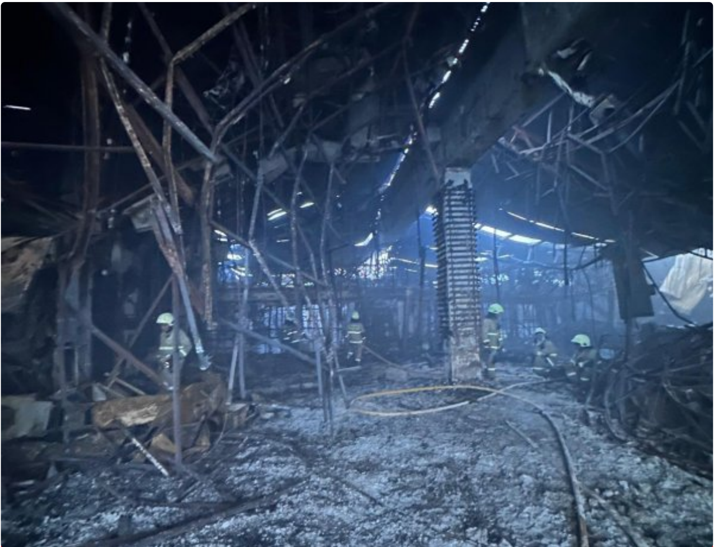
Glodok Plaza yang Hangus Terbakar
